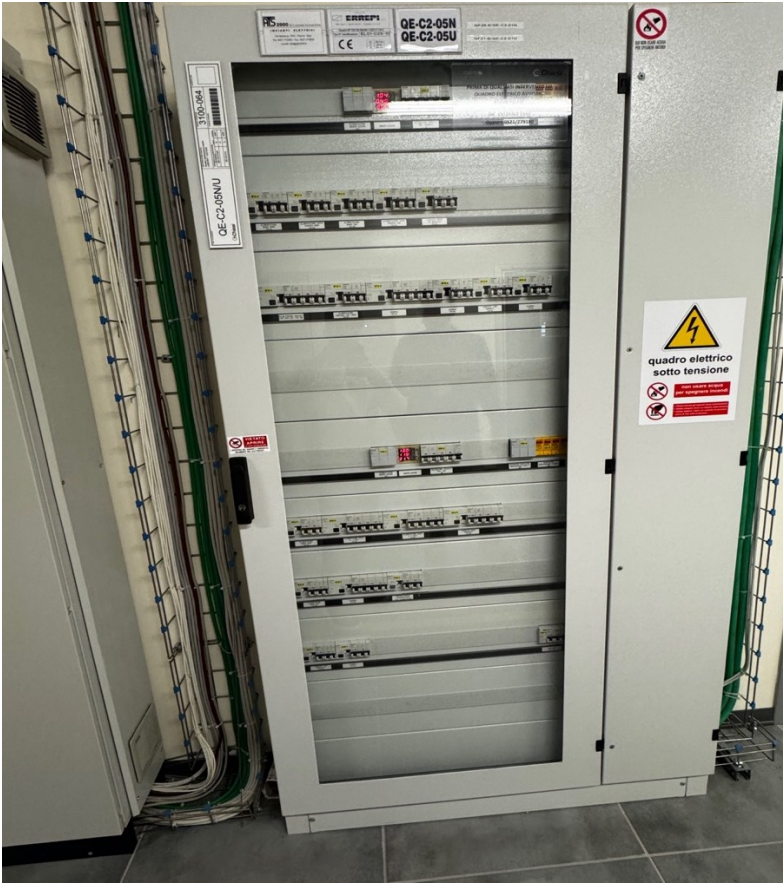
Fig 4.2 - Quadro elettrico al piano C2
