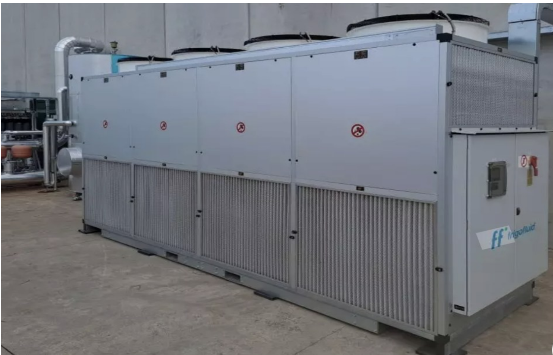
Fig 2.4 - Chiller per produzione acqua refrigerata
