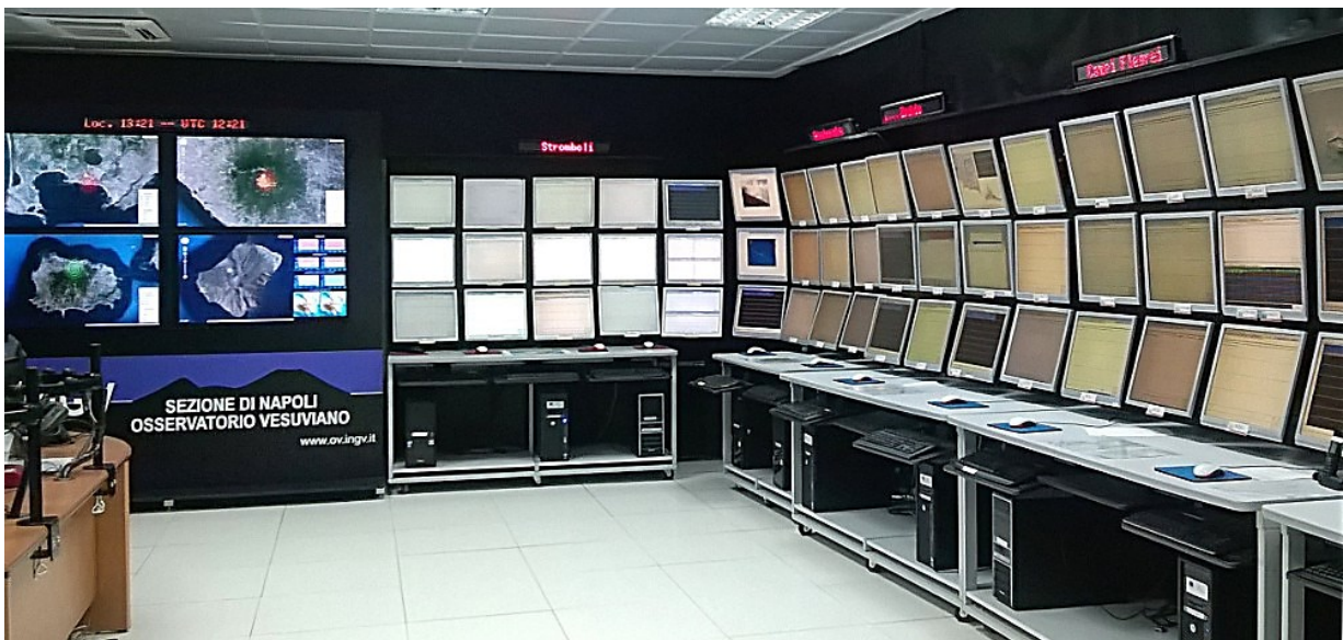
Fig.16: Sala di Monitoraggio dell'Osservatorio Vesuviano (fonte: Peluso et al., post blog INGVvulcani, 26/03/2021).
