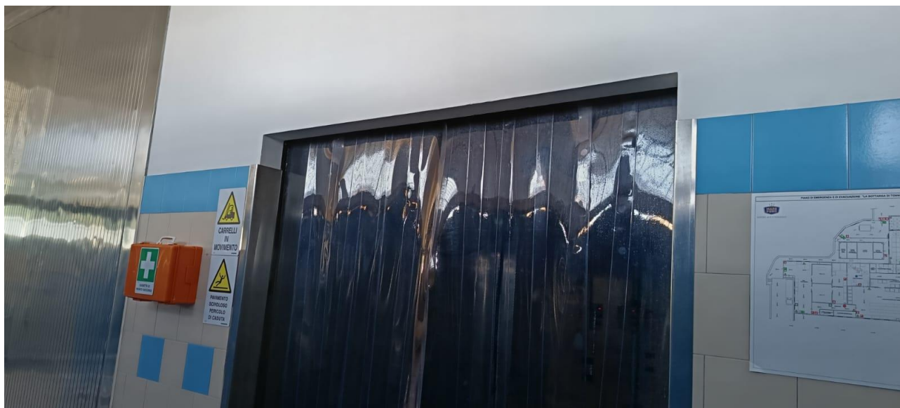
BRC 4.4.1/IFS 4.9.2.2: Foto porzione soffitto
