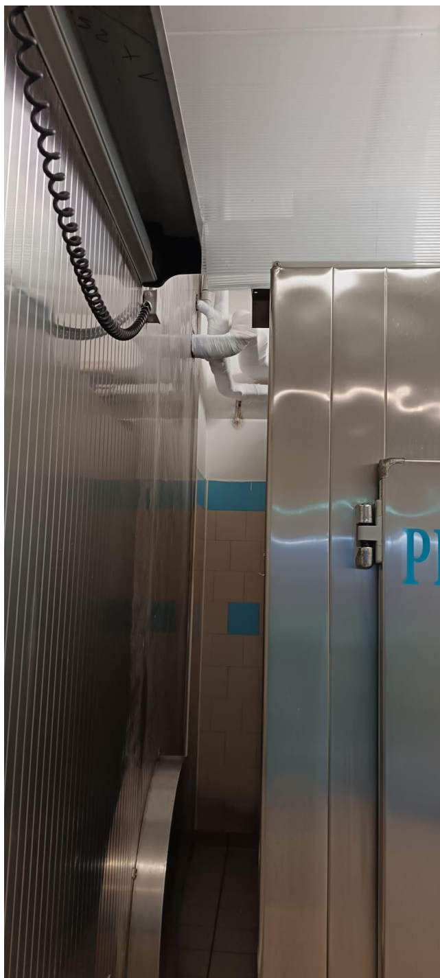
BRC 4.7.3/IFS 4.16.5: Foto coibentazione tubazioni
