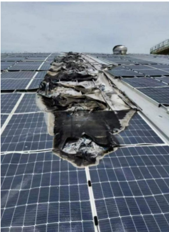
Figura 5.4 Immagine di un incendio sui pannelli FV
